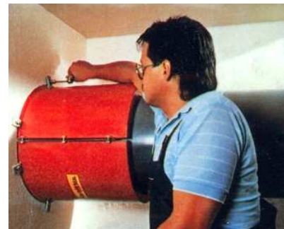
Rohrabschottung für brennbare Rohre
